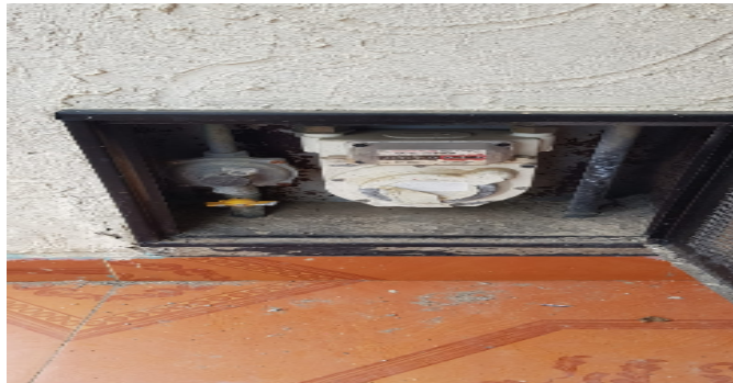
Contador de Gas
