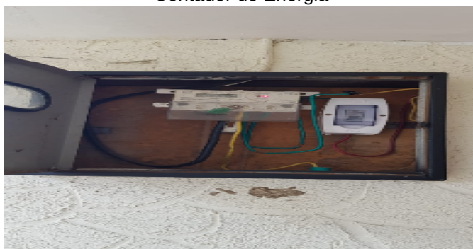
Contador de Energia
