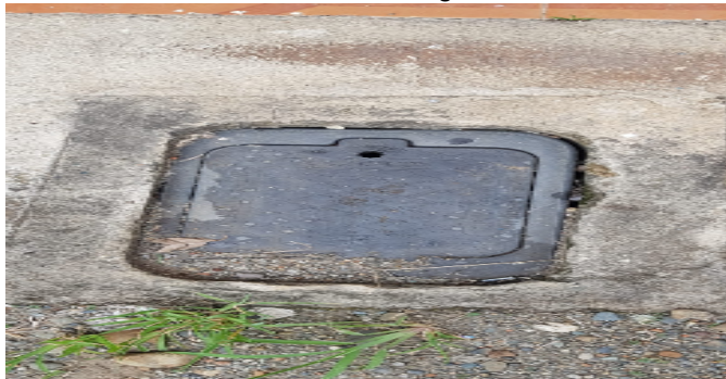
Contador de Agua
