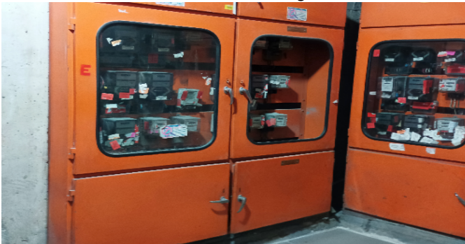
Contador de Energia
