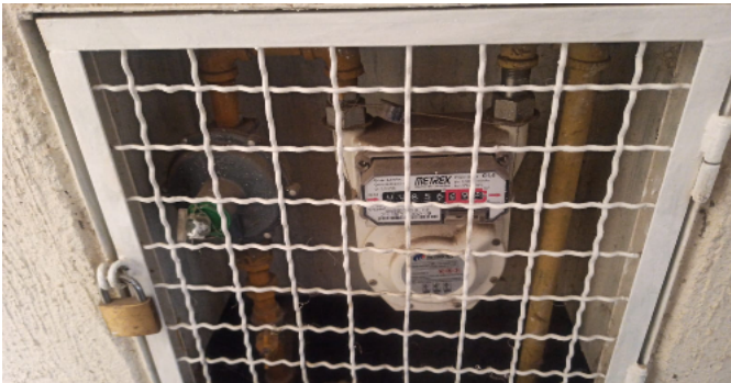
Contador de Gas
