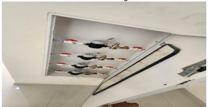
Contador de Agua
