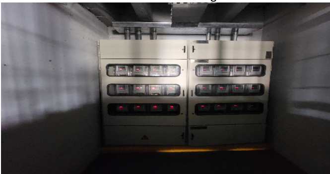
Contador de Energia
