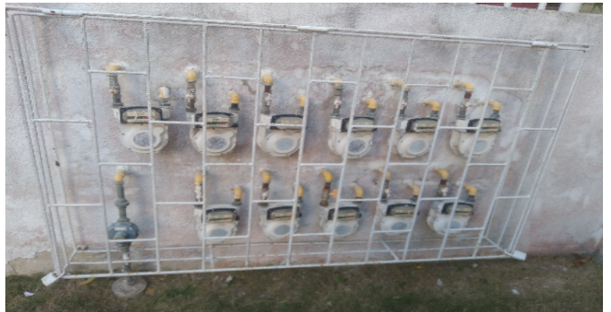
Contador de Gas
