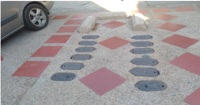
Contador de Agua
