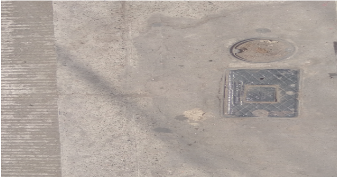
Contador de Agua
