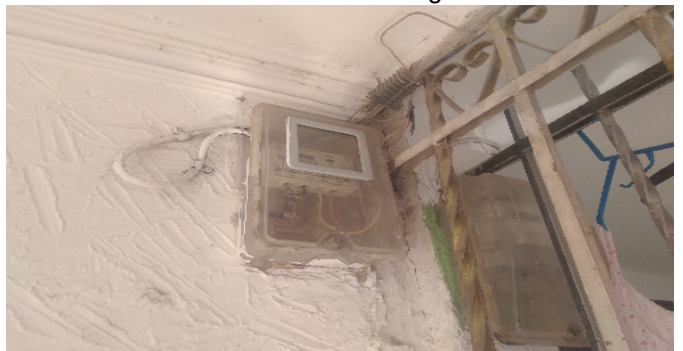
Contador de Energia
