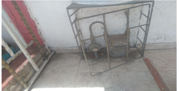
Contador de Gas
