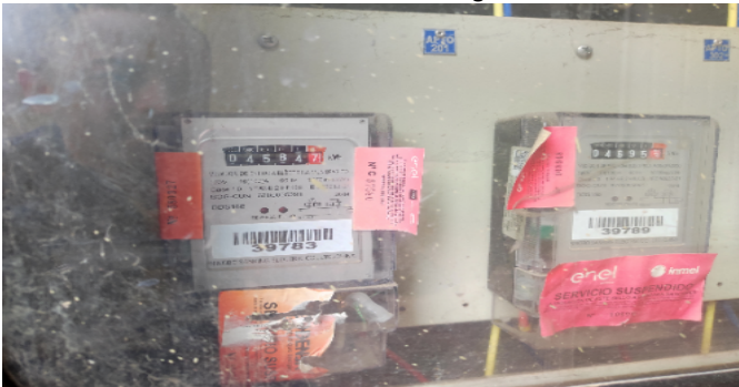
Contador de Energia
