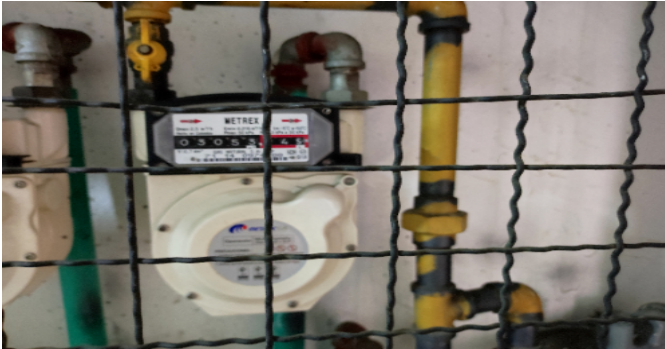
Contador de Gas
