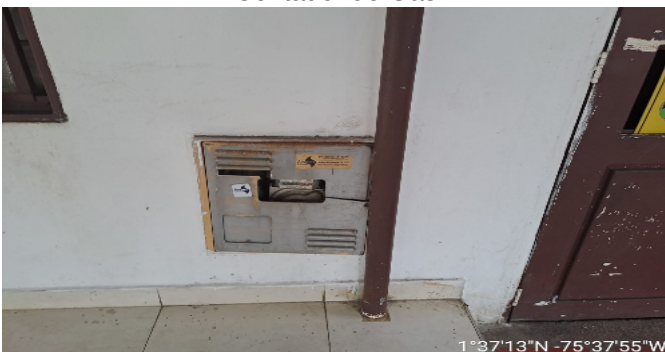
Contador de Gas
