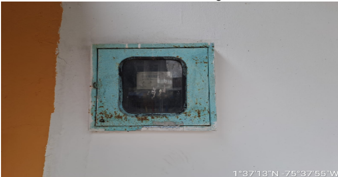
Contador de Energia
