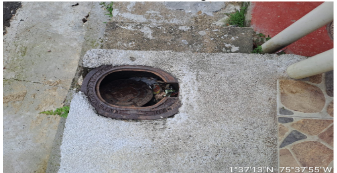
Contador de Agua
