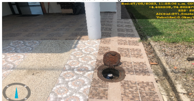
Contador de Agua
