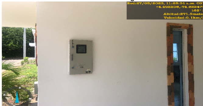
Contador de Energia
