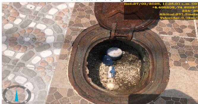
Contador de Agua
