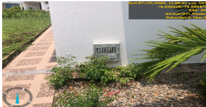
Contador de Gas
