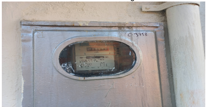
Contador de Energia
