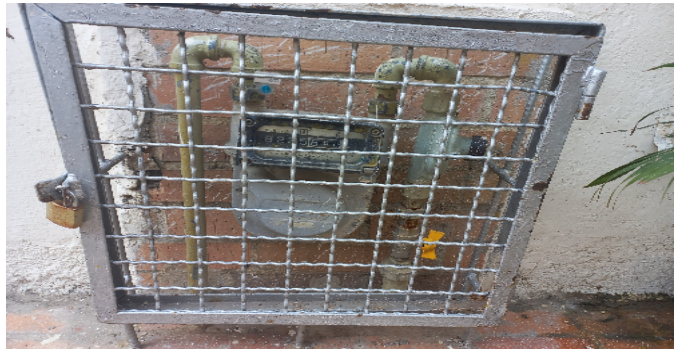
Contador de Gas
