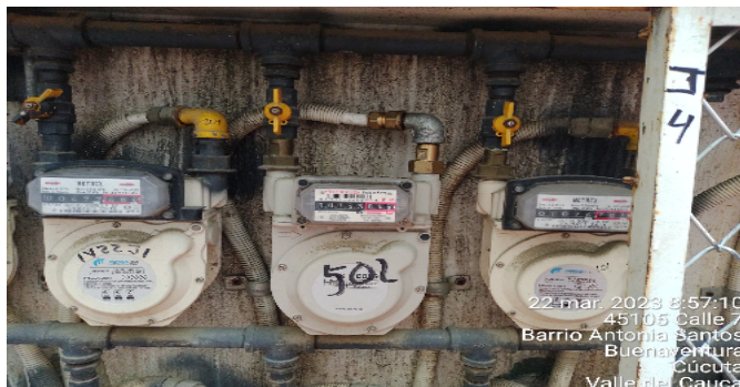
Contador de Gas
