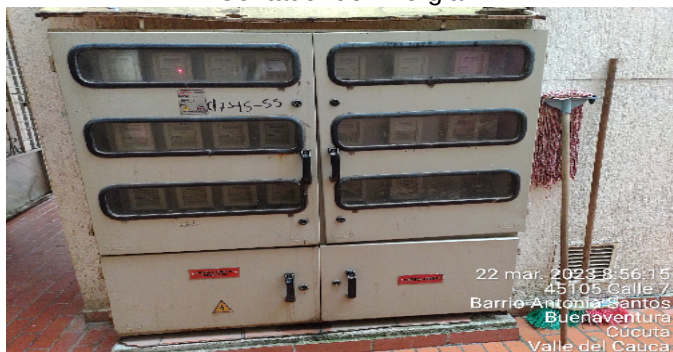
Contador de Energia
