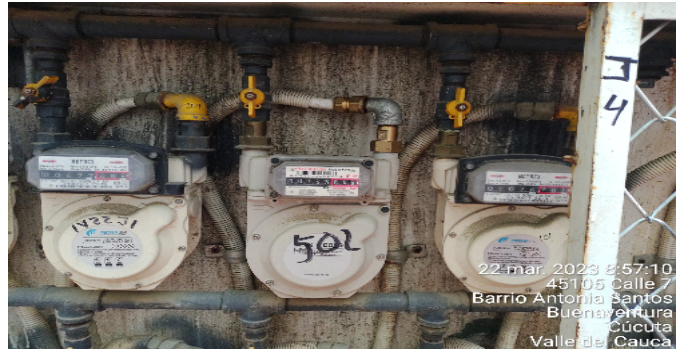
Contador de Gas
