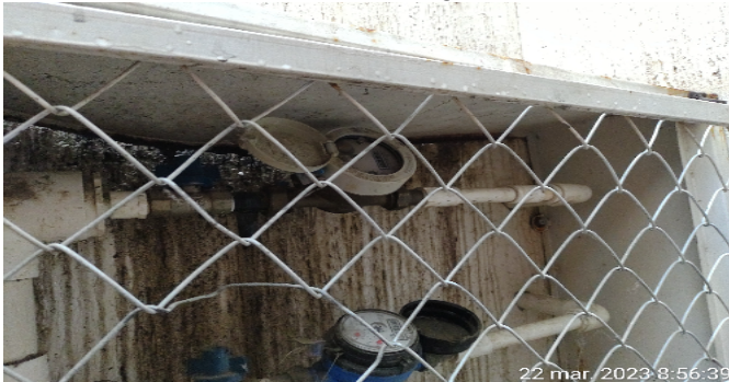
Contador de Agua
