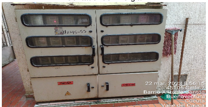
Contador de Energia
