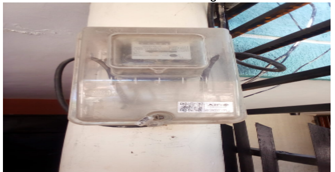
Contador de Energia
