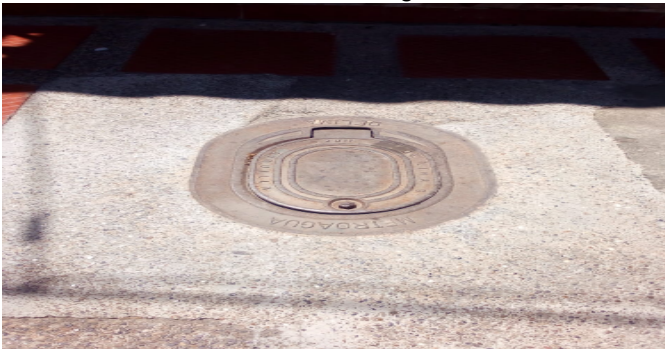
Contador de Agua
