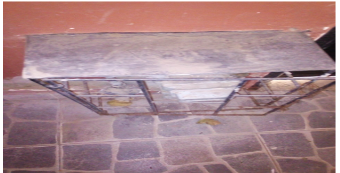
Contador de Gas
