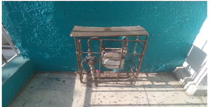
Contador de Gas
