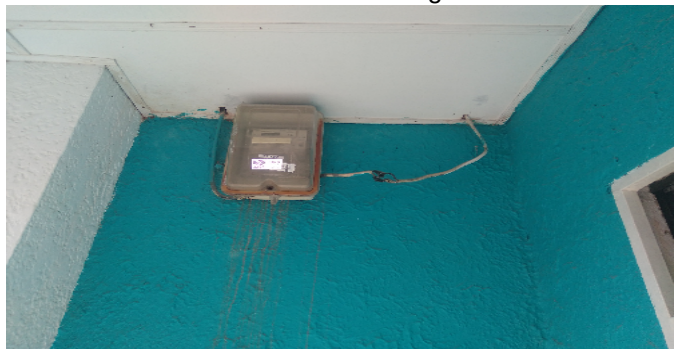
Contador de Energia
