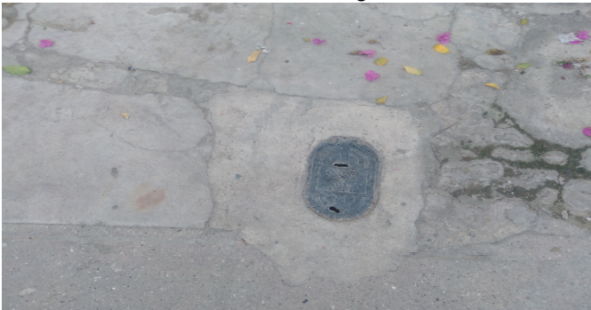
Contador de Agua
