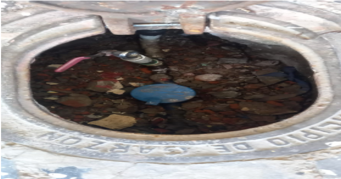
Contador de Agua
