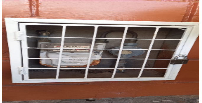
Contador de Gas
