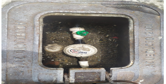
Contador de Agua
