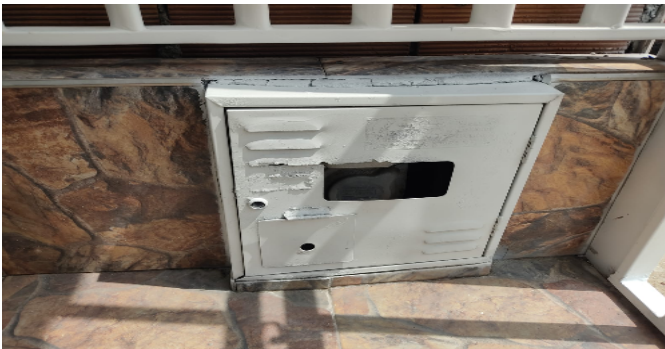
Contador de Gas
