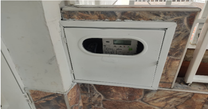
Contador de Energia
