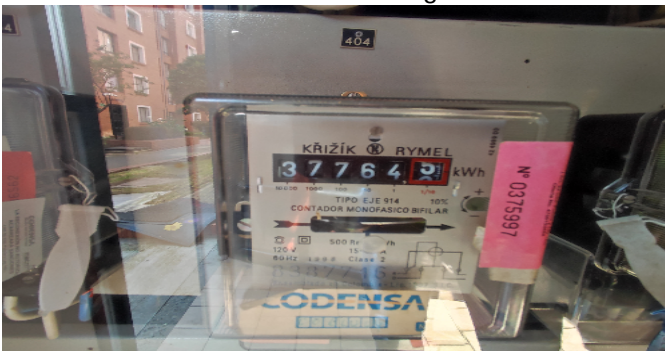
Contador de Energia
