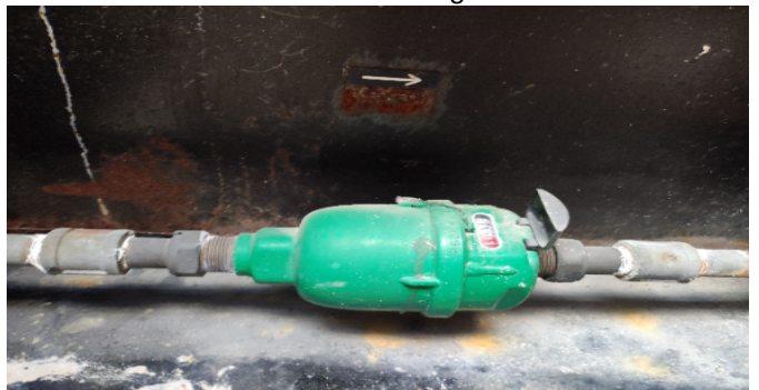
Contador de Agua
