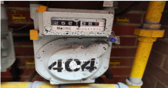
Contador de Gas
