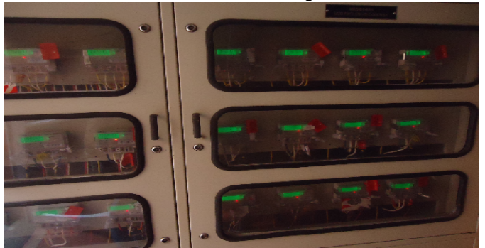
Contador de Energia
