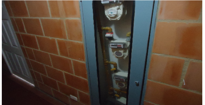
Contador de Gas
