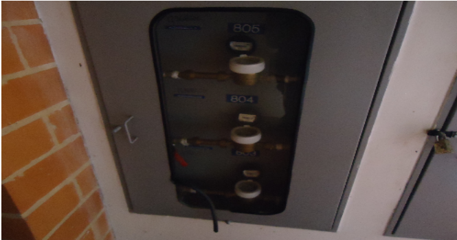
Contador de Agua
