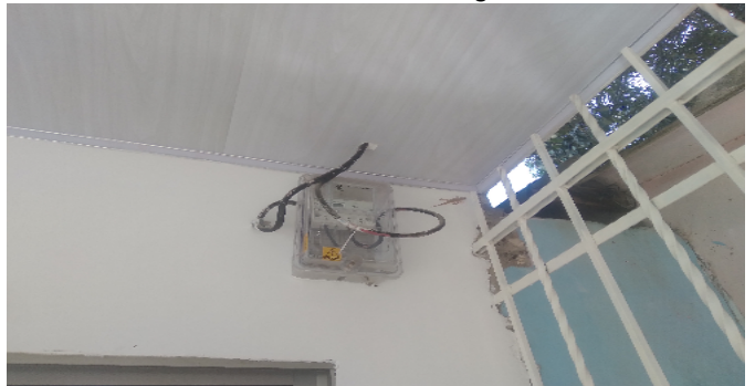
Contador de Energia
