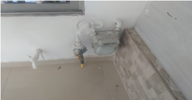
Contador de Gas
