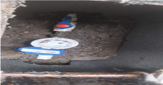
Contador de Agua
