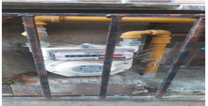
Contador de Gas
