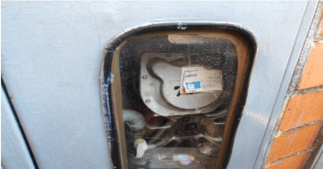
Contador de Gas
