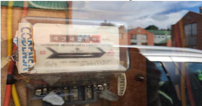
Contador de Energia
