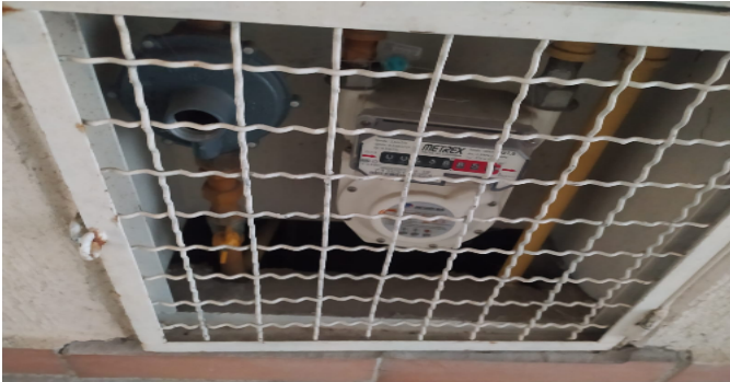
Contador de Gas
