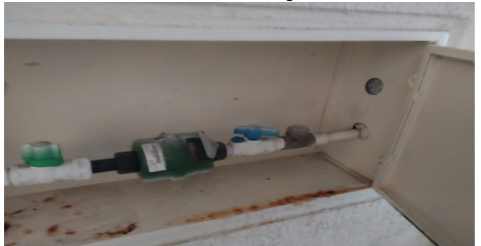
Contador de Agua
