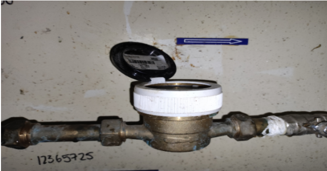
Contador de Agua
