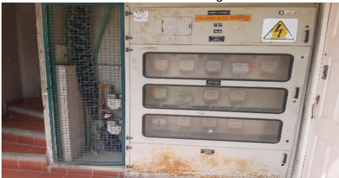
Contador de Energia
