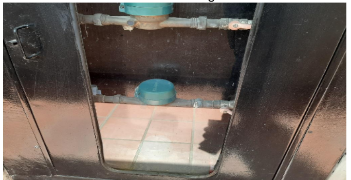
Contador de Agua
