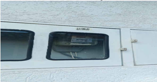
Contador de Energia
