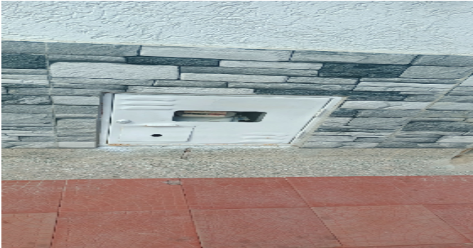
Contador de Gas
