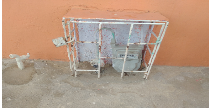
Contador de Gas
