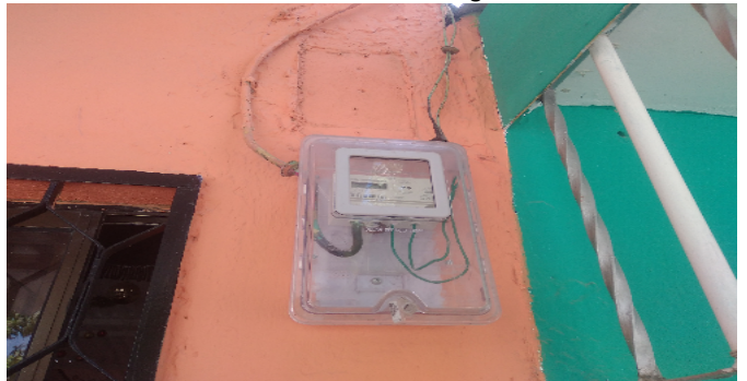
Contador de Energia
