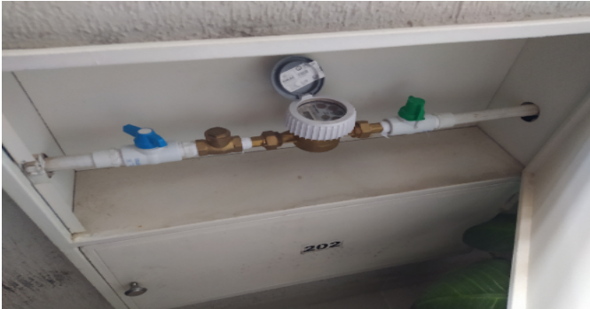
Contador de Agua
