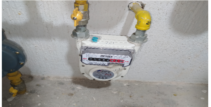
Contador de Gas
