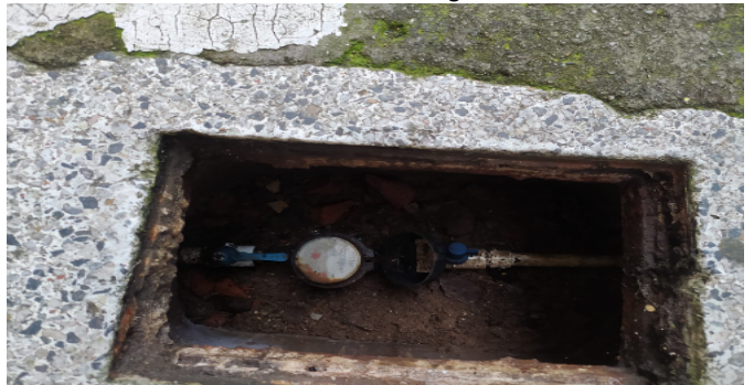
Contador de Agua
