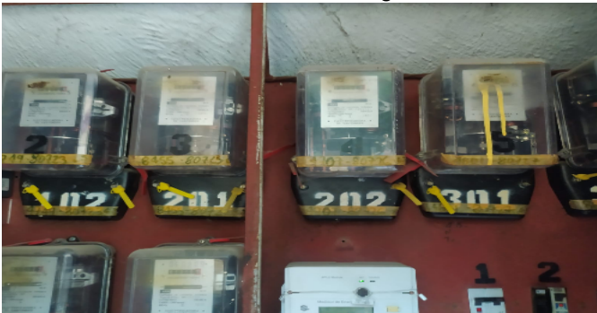
Contador de Energia
