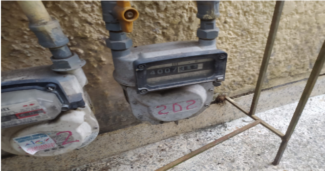
Contador de Gas
