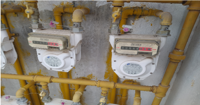
Contador de Gas
