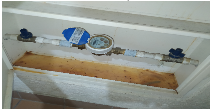
Contador de Agua
