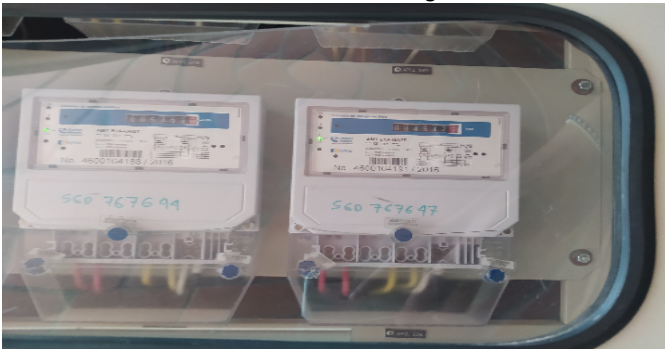
Contador de Energia
