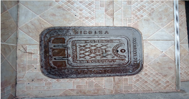
Contador de Agua
