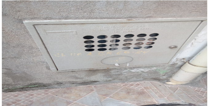
Contador de Gas
