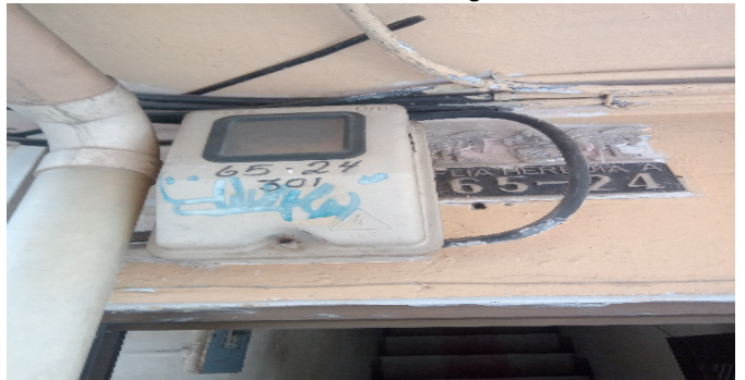
Contador de Energia
