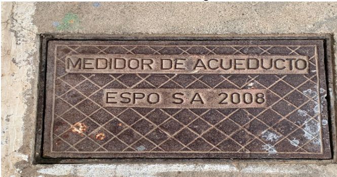
Contador de Agua
