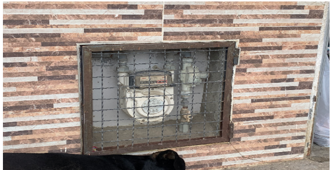
Contador de Gas
