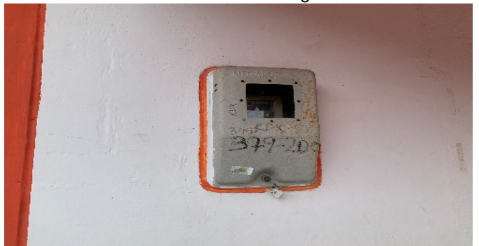
Contador de Energia
