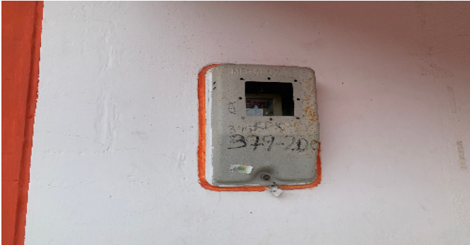
Contador de Energia
