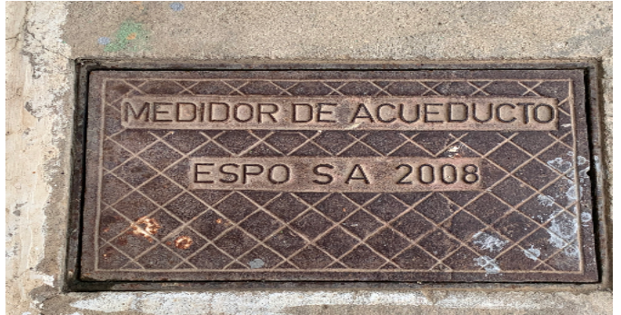
Contador de Agua
