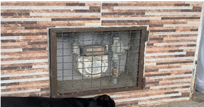
Contador de Gas
