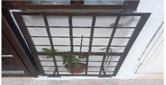
Contador de Gas
