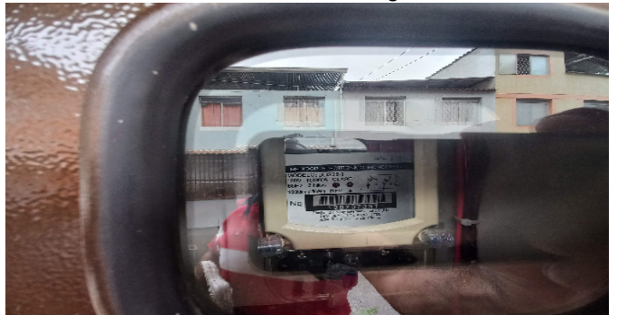
Contador de Energia
