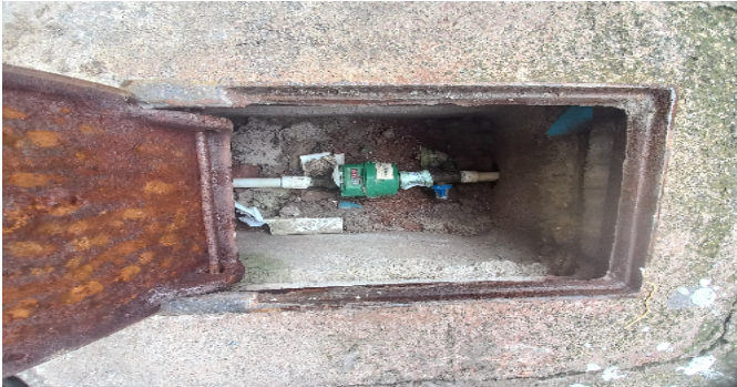
Contador de Agua
