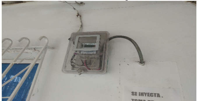
Contador de Energia
