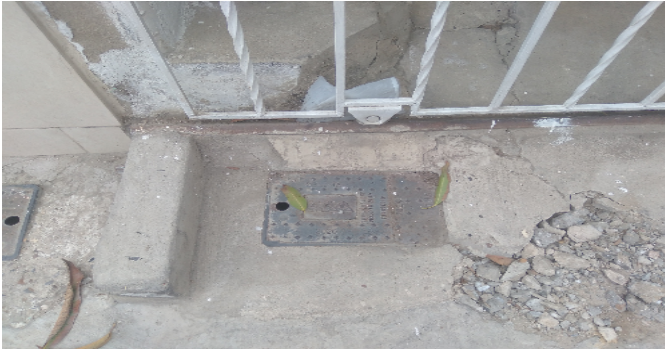
Contador de Agua
