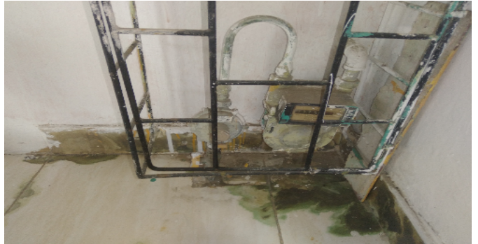
Contador de Gas
