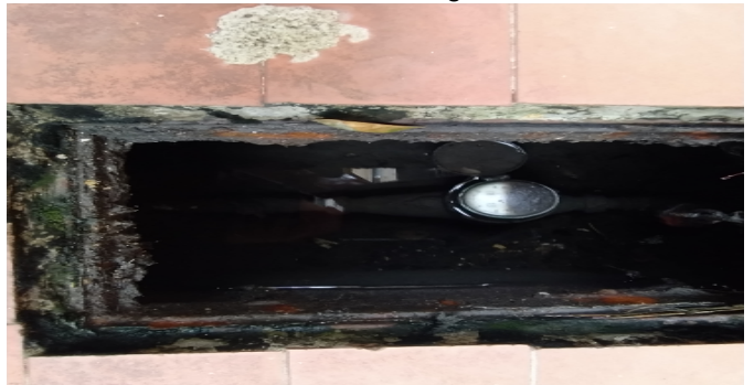
Contador de Agua
