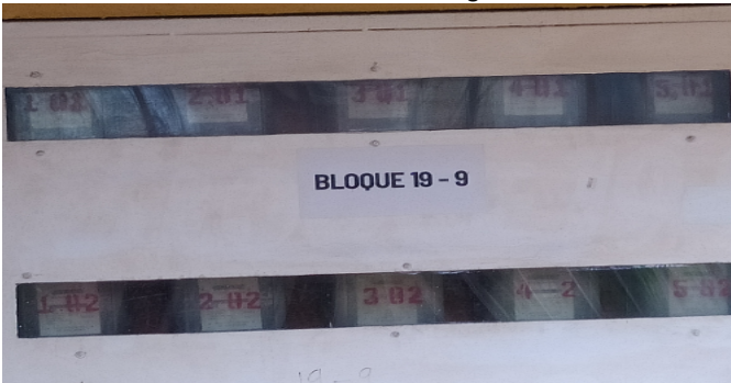
Contador de Energia
