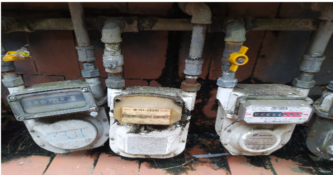
Contador de Gas
