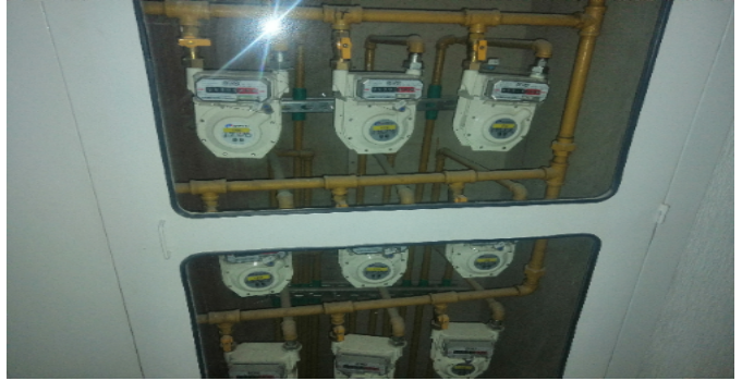
Contador de Gas
