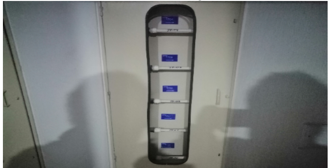
Contador de Agua
