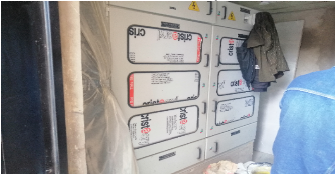
Contador de Energia
