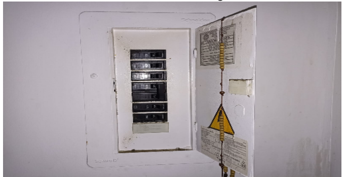
Contador de Energia
