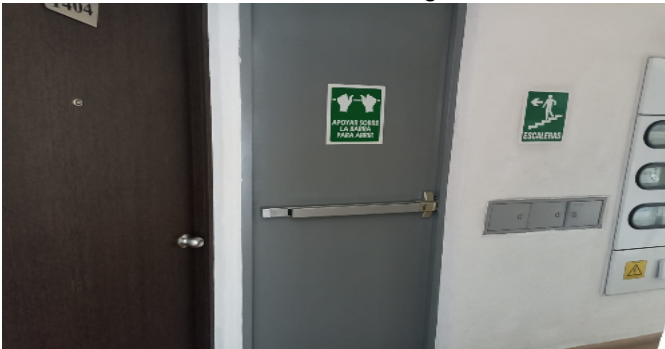
Contador de Energia
