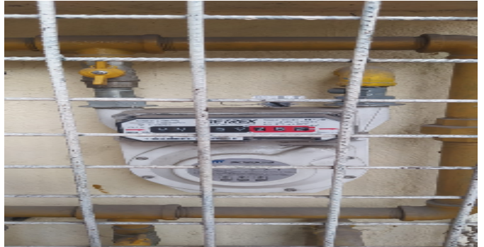
Contador de Gas
