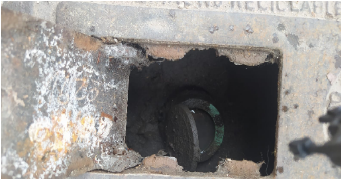
Contador de Agua
