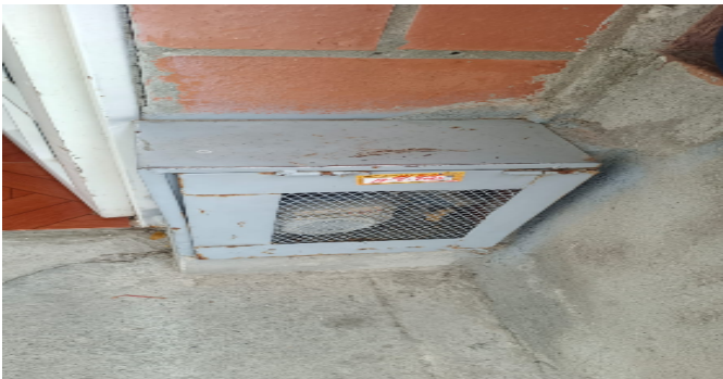
Contador de Gas
