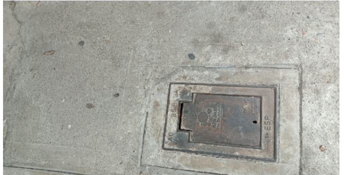
Contador de Agua
