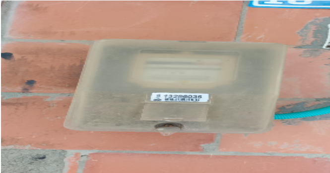
Contador de Energia
