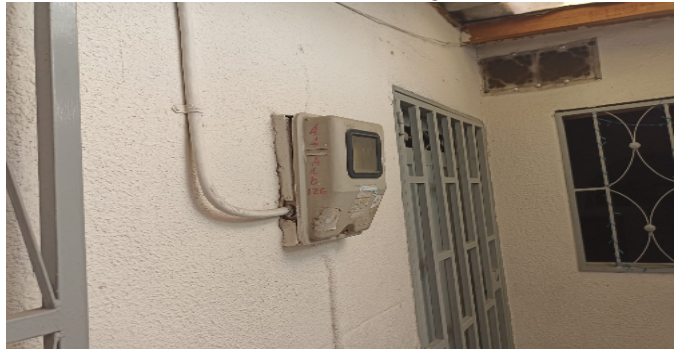
Contador de Energia
