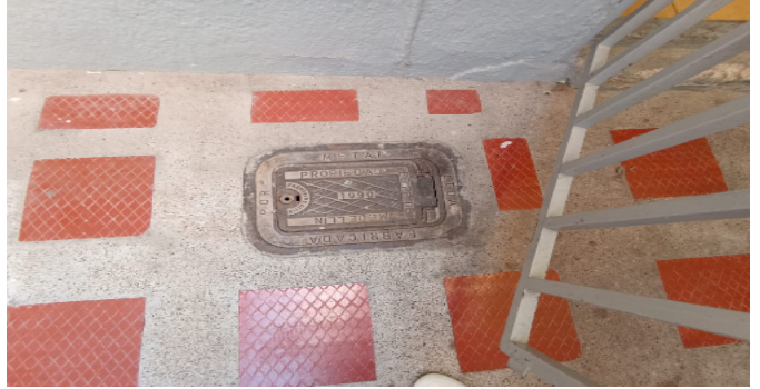
Contador de Agua
