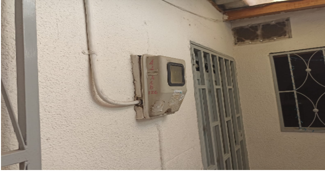
Contador de Energia
