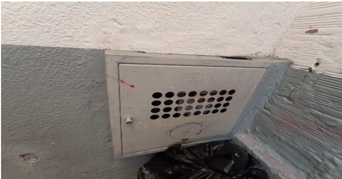
Contador de Gas
