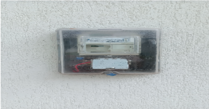
Contador de Energia
