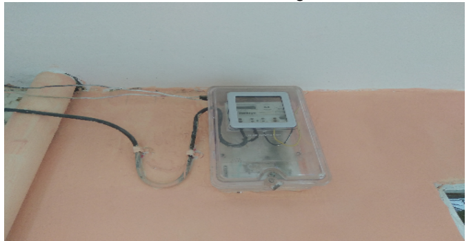
Contador de Energia
