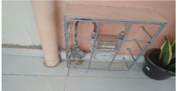
Contador de Gas
