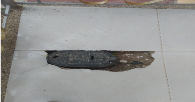
Contador de Agua
