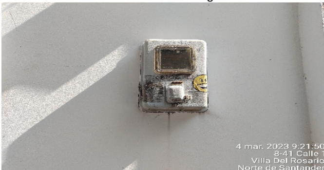
Contador de Energia
