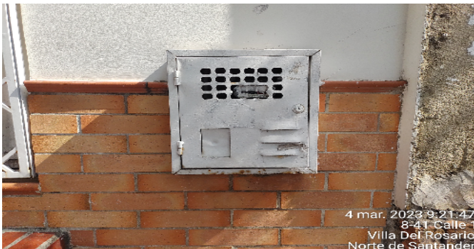
Contador de Gas
