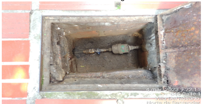
Contador de Agua
