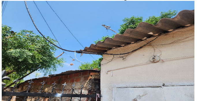
Contador de Energia
