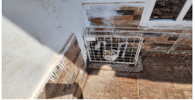
Contador de Gas
