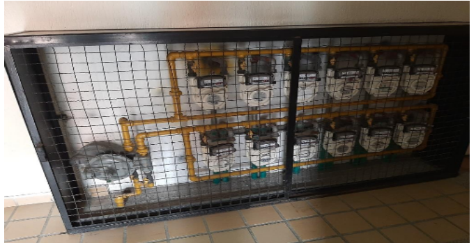
Contador de Gas
