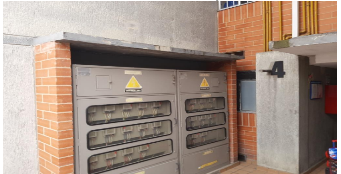
Contador de Energia
