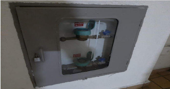
Contador de Agua
