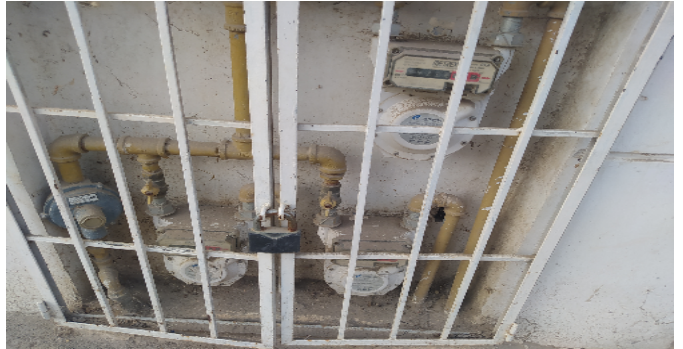
Contador de Gas
