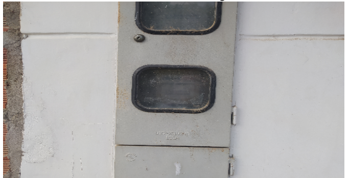
Contador de Energia
