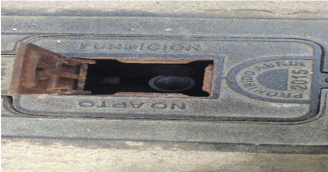
Contador de Agua
