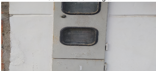
Contador de Energia
