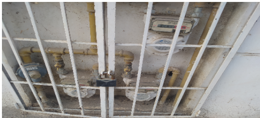
Contador de Gas
