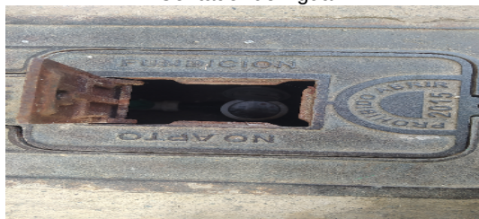
Contador de Agua
