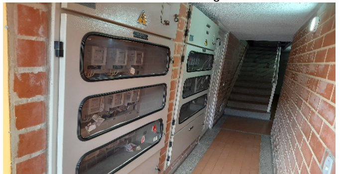
Contador de Energia
