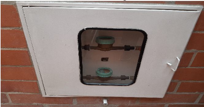
Contador de Agua
