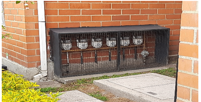
Contador de Gas
