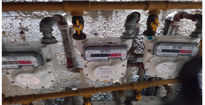
Contador de Gas
