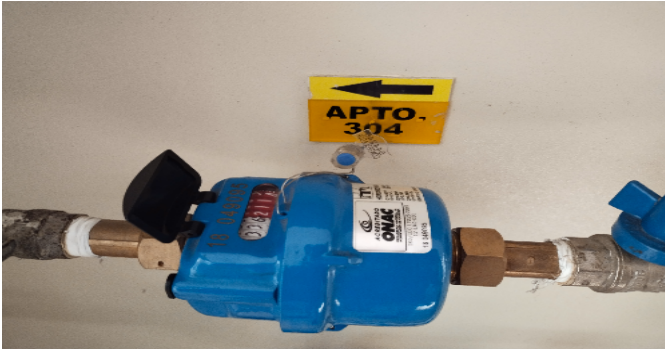
Contador de Agua
