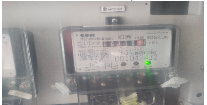
Contador de Energia
